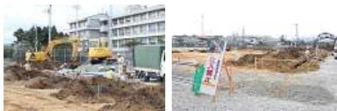
▲下水道を設置する作業員▲着工前に表土除去も行われました
